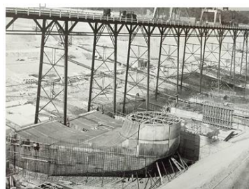
Vue des aspirateurs durant la construction de l'usine
